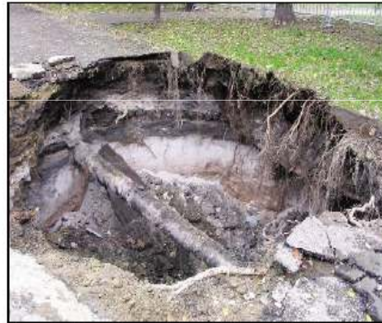
Sosnowiec (kop. „Sosnowiec”); zapadlisko o głębokości 3–5 m, powstałe w nagły sposób przy ul. 1 Maja w czwartek br. na obszarze dawnej płytowej eksploatacji
